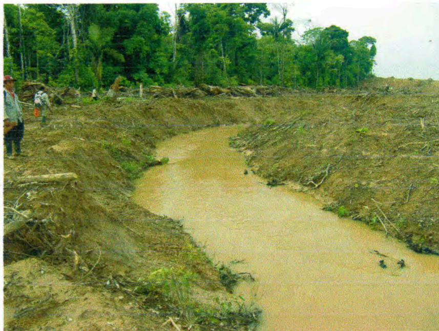
FOTO 12: QUEBRADA BOAYO, DESVÍO DE CURSO POR LA EMPRESA PLANTACIONES DE UCAYALI EN EL CASERÍO BAJO RAYAL – NUEVA REQUENA – CORONEL PORTILLO – UCAYALI
